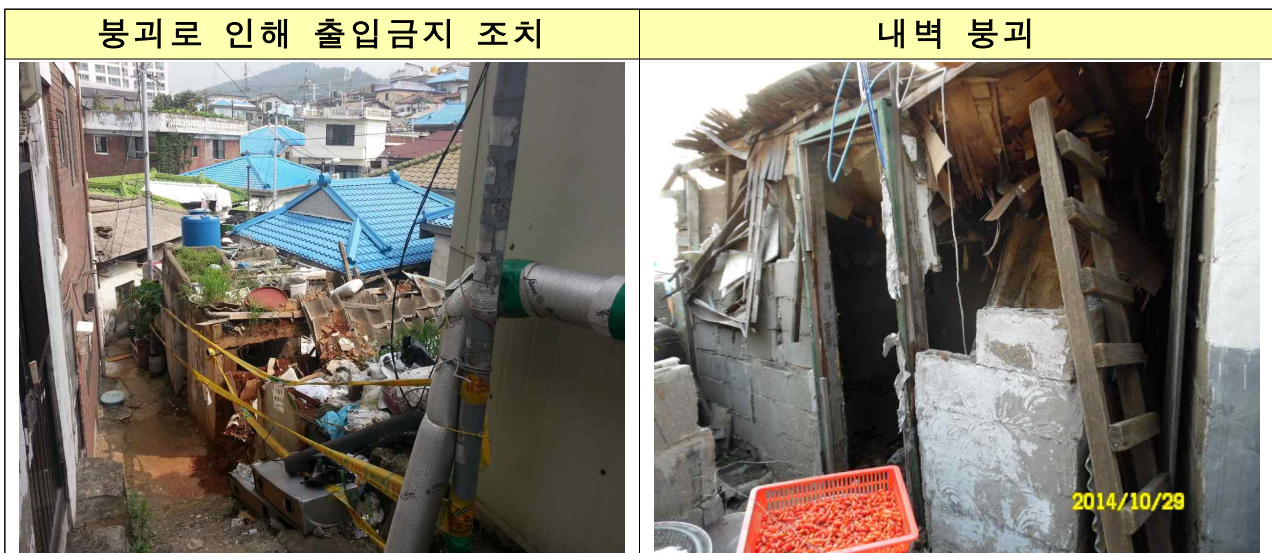
【십정2 주거환경개선구역 주택붕괴 현장】
